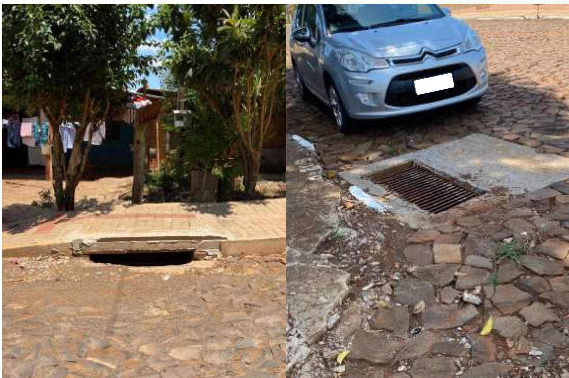
Figura 46: Boca de lobo do tipo guia e do tipo grelha em rua com pavimento asfáltico e calçamento.
