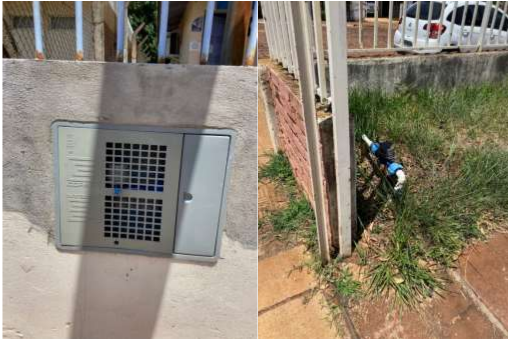
Figura 29: Medidor de água Padrão CORSAN (à esquerda) Medidor de água irregular (à direita).
