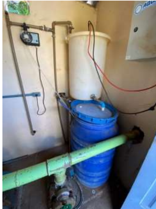
Figura 9: Casa de química-poço NON-05.
