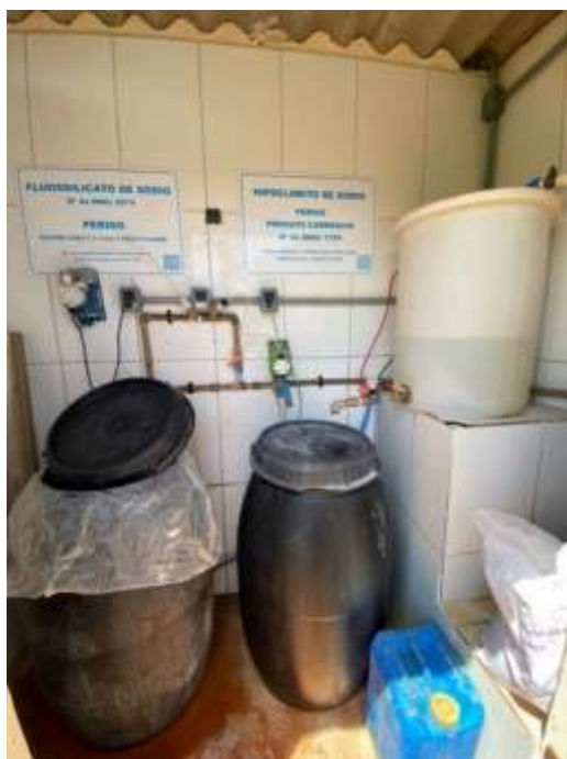
Figura 12: Casa de Química Poço NON-08.
