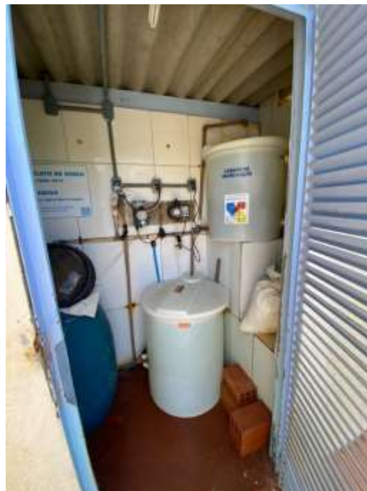
Figura 14: Casa de Química Poço NON-09.
