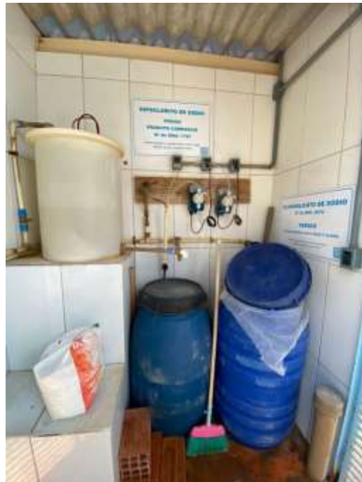
Figura 7. Casa de química-poço NON-04.
