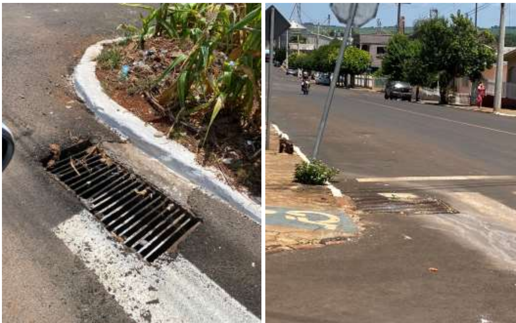
Figura 44: Boca de lobo tipo grelha.
