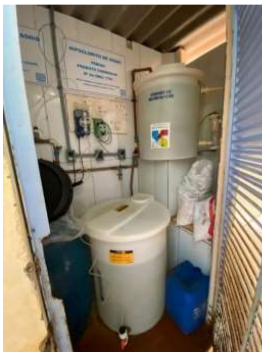
Figura 16: Casa de Química Poço NON-22.
