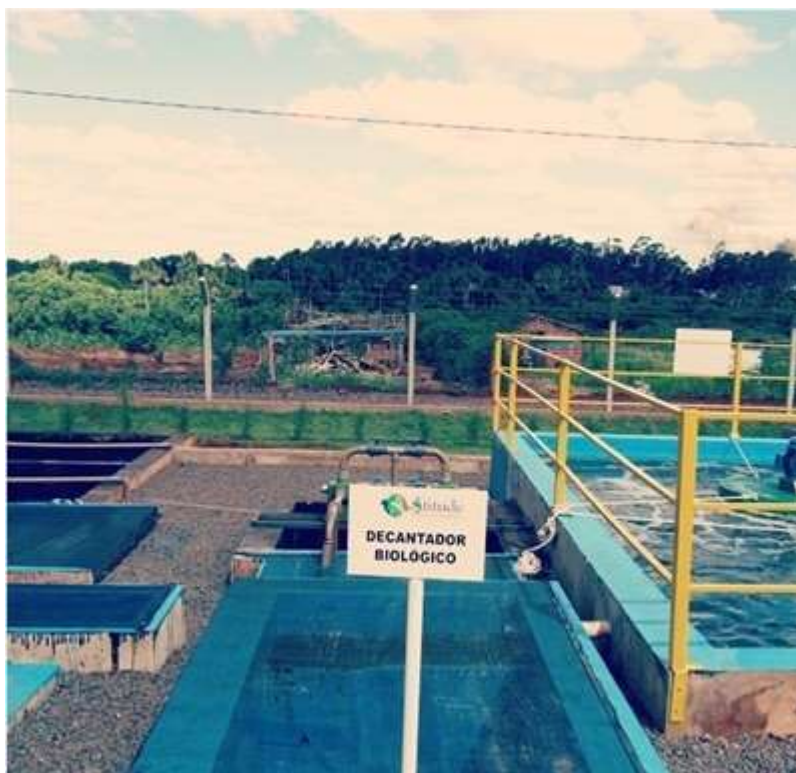
Figura 60: ETE da empresa Atitude Ambiental.
