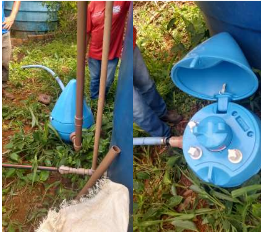
Figura 30: Dosador de cloro hidráulico, tipo gota.
